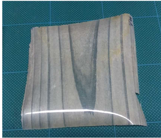
剥離した塗膜
