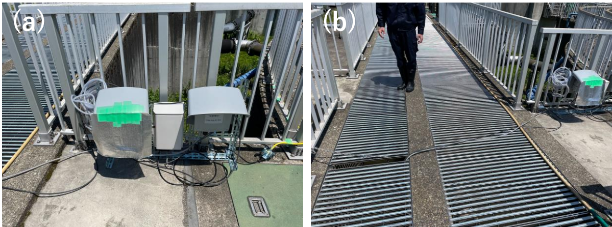
図 5 - 3 反応槽への流入地点に設置した (a) 水質測定用コントローラー (b) 水質測定用コントローラーに接続した NH 4 + センサーを浸漬させた状況 (図 5 - 1 参照)
