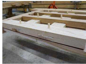
写真3 補強材の浮き上がり
