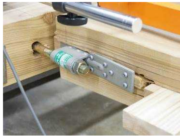
写真2 金物ビス部分の抜け
