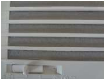
写真 10 排気口フィルターの状況 (K 邸)。
