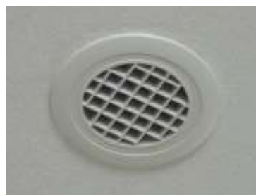
写真4 1階排気口 (B邸, 設置位置: 天井面)。
