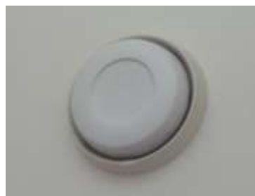
写真3 自然給気口 (B邸, 設置位置: 壁面)。
