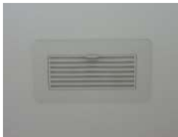
写真6 給気口 (K 邸, 設置位置: 天井面).
