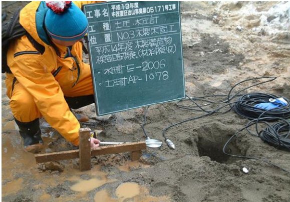
堤体底部の土圧計、水圧計
