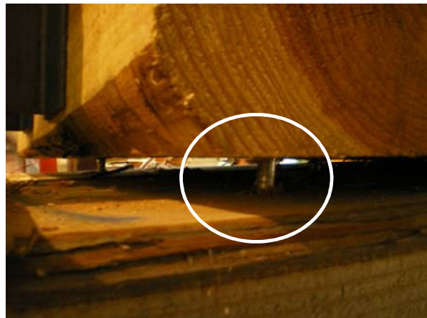
写真 1.22 上流側ラグスクリューの引き抜け
