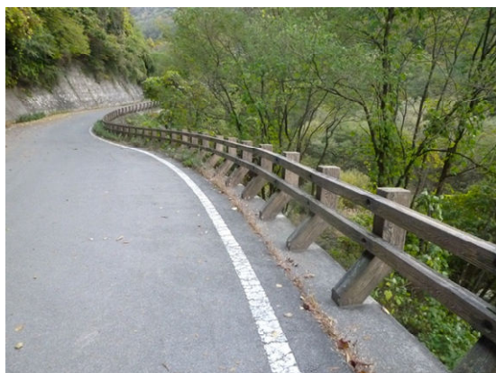
写真 1.3 木製ガードレール
