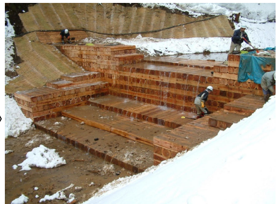
⑥ダム下流側に水叩き工を、上流 側に土砂を埋め戻して完成
