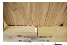
下弦材継ぎ手部分 下弦材の欠けにより生じた合板との隙間による接着不良 (909-3)
