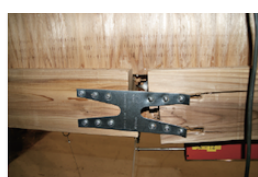
下弦材継ぎ手部の破壊 (455-3) — 接着不良により下弦材スリットと合板の間にずれが発生
