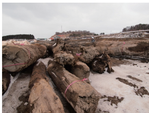
図3 工事現場に集積された埋もれ木の様子
